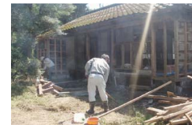
集落内の空き家を住民の力で改修、大野への移住を決めた市外出身の若者延べ5名を受け入れている。県・市の支援事業を活用し、平成24・25・27年度で3軒のリフォームを完了。
