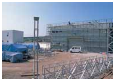
▲島民の期待を集めて建設が進む池島アーバンマイン(株)。廃車から金属類を取り出す等の環境事業を行うという
