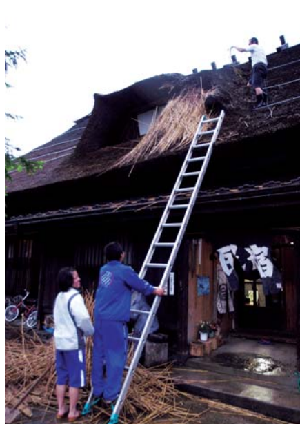
台風の襲来で、家族総出で茅葺き屋根の保護と修理に当たる
