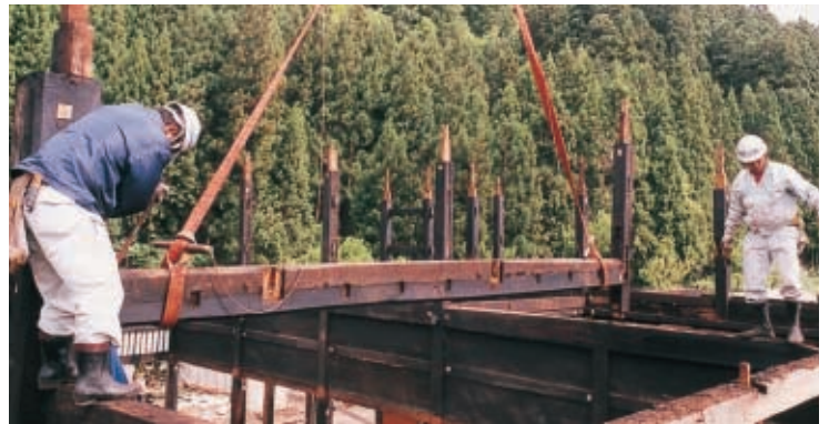
梁はさすがクレーンで下ろされる。解体作業もほぼ終盤だ（撮影／小林政一）
