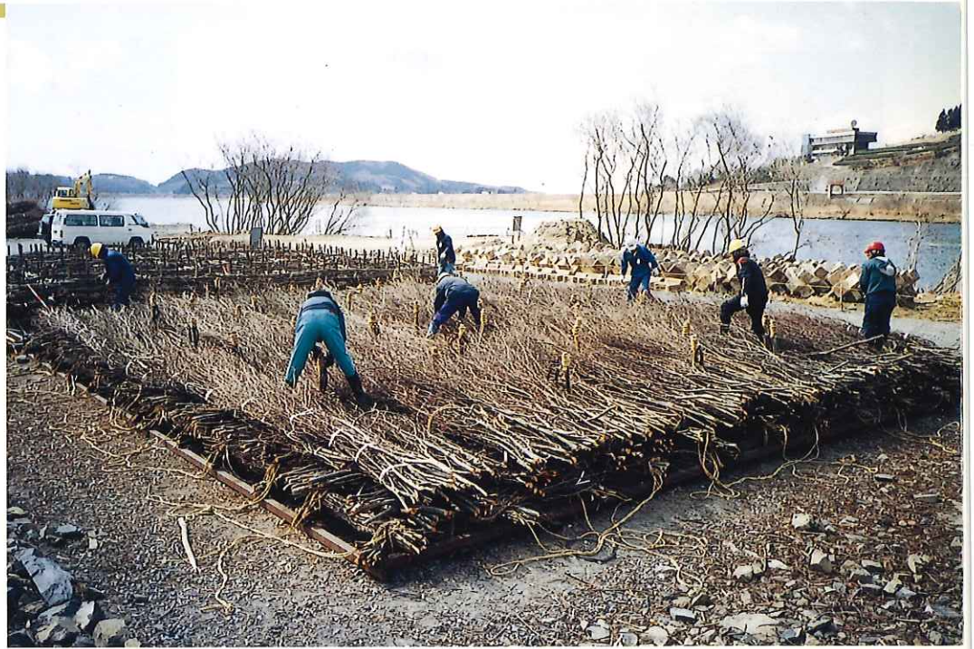
粗朶木をマット状に編む(3層目)。北上川河岸で(提供/前田建設工業)
