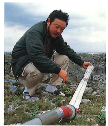
▲海水を半地下のタンクに汲み上げる
