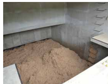
▼バイオマスボイラー室。集積したチップと機器を説明する山本さん
