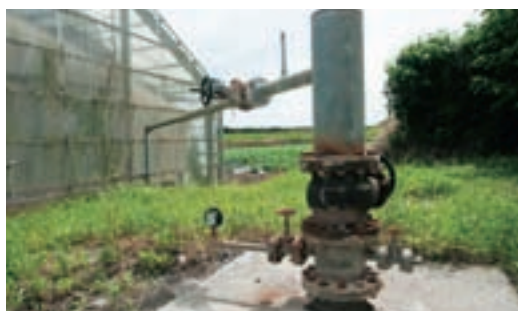
▲室屋植物園の地熱蒸気取り入れ口
