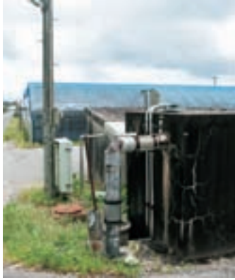
▼温室の中に温泉を通すパイプ
