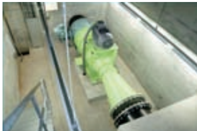
▲6mの落差を利用した小水力発電所
