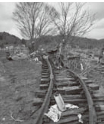
▼宮古市高浜、崩壊した線路
