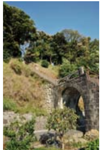
▲法恩寺跨線橋。昭和6年に参道として造られたコンクリート橋
