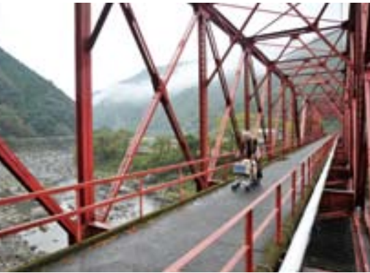
▲昭和7年建造の小島橋。鋼トラス橋とガーター橋を組み合わせた全長143m、森林鉄道の中では最も大規模な橋
